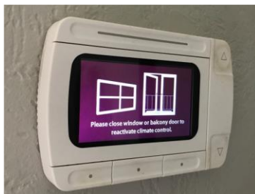
شکل ۹: دستگاه کنترل خودکار خاموشی تهویه مطبوع هنگام تهویه طبیعی
